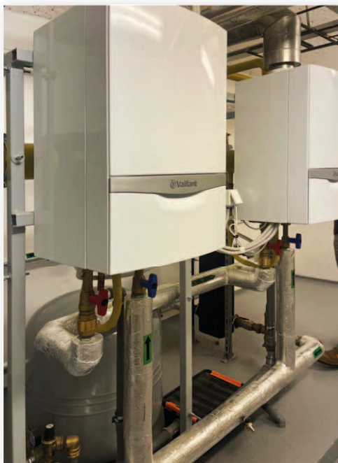
Nově zrekonstruovaná kotelna v ZŠ Senohraby
